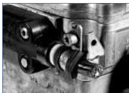
Beschädigung an Kabeln bei EDC Verteilereinspritzung
