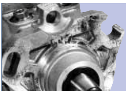
Beschädigung an Antriebswelle/-flansch, Verfärbung durch Überhitzung
